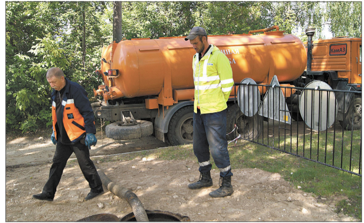
Откачивание канализационных стоков на ул. III Интернационала.
