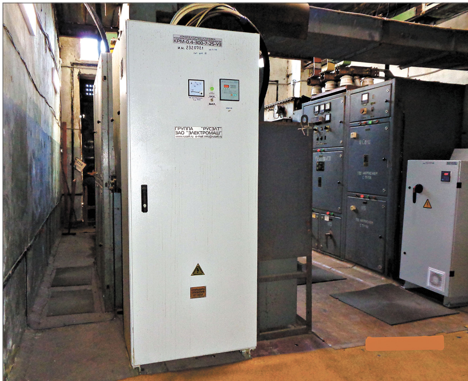
Конденсаторная установка. Цех №60.
