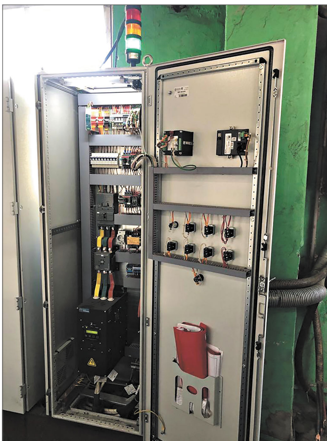
Шкаф управления вакуумной печи. Цех №43.
