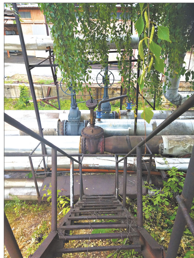
Тепловая сеть первого контура от ЦТП № 1 до корпуса «В».
