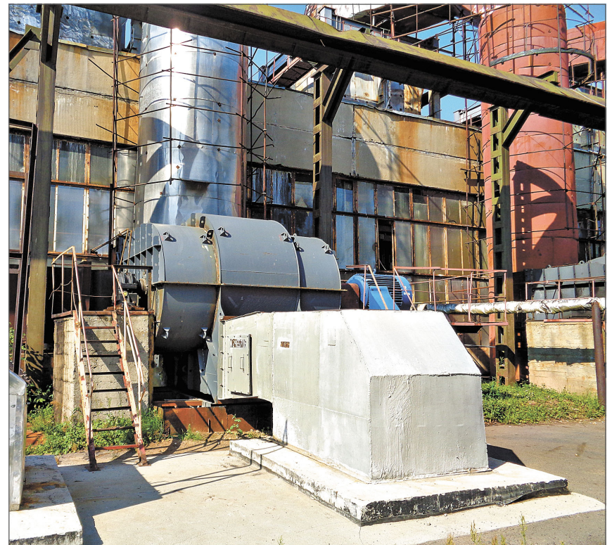
Дымосос котла ПТВМ №2 в котельной №4.
