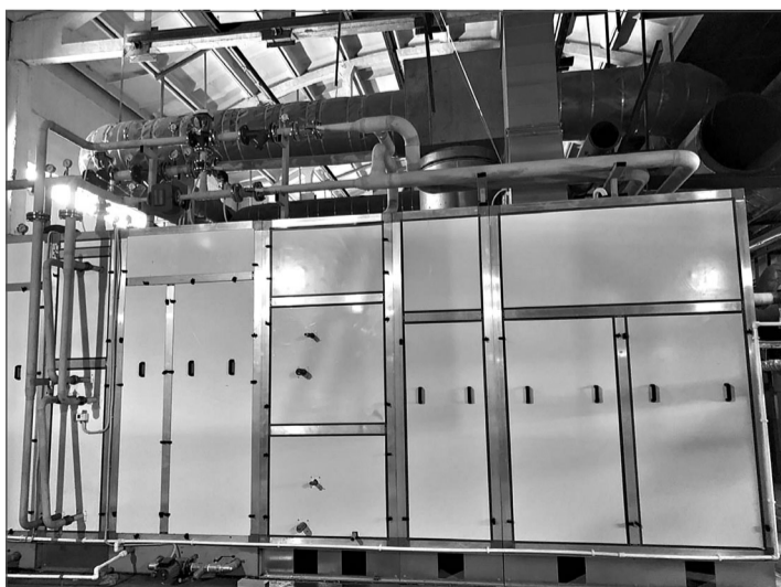
Приточная вентиляция корпуса «110» производства №9.
