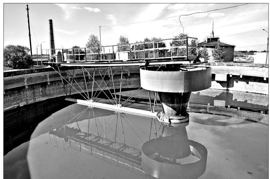
Очистные сооружения. 2010 год.
