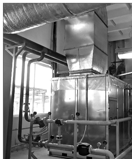
Приточная вентиляция корпуса «К» производства № 9 отделения № 3.
