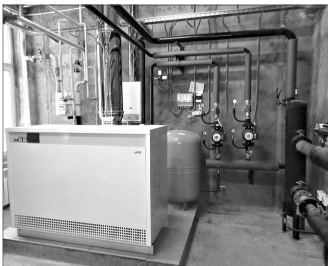
Котельная ГКНС, ул. Староклязьменская площадь, 10.
